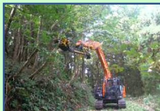
フェラバンチャ（立木、竹、高所作業等）
